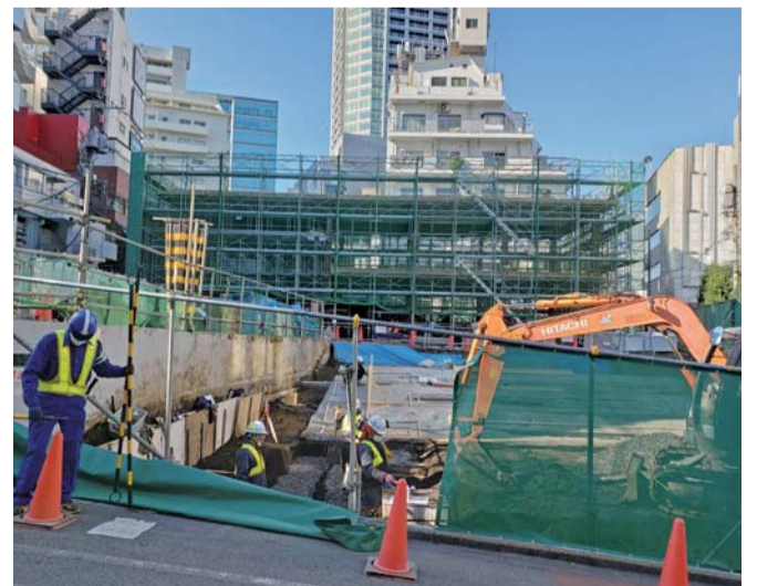
公園面積の2割をカフェなどの建物が占める北谷公園(建設中)。後方にあるのは区役所本庁舎
